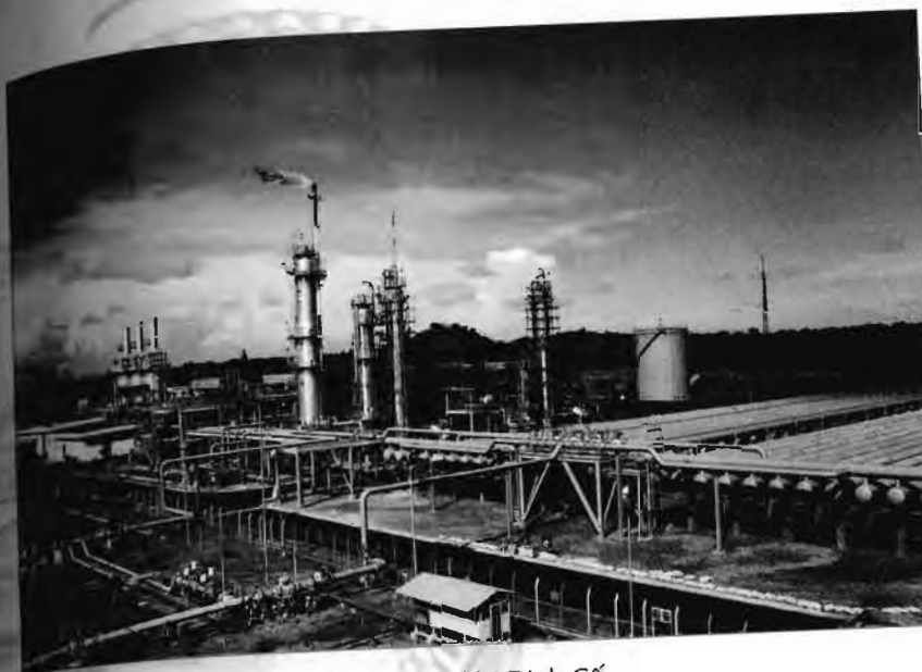
Nhà máy xử lý khí Dinh Cổ Dinh Co gas processing plant
