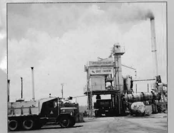
Trạm trộn bê tông nhựa nóng ASPHALT CONCRETE MIXING PLANT
