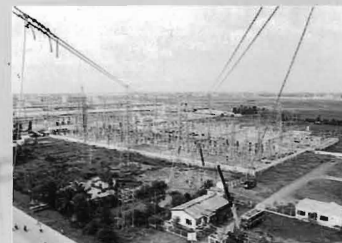
Trạm 500/200/110/35KV Phú Lâm, công suất 900MVA. Phú Lâm 500/220/110/35KV substation, 900MVA.
