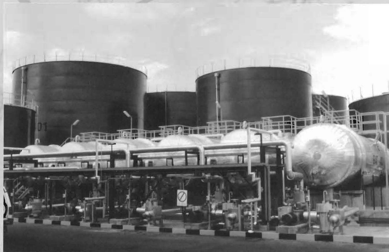
Bồn bể Nhà máy dầu mỡ BP - TP Hồ Chí Minh. BP oil tanks
