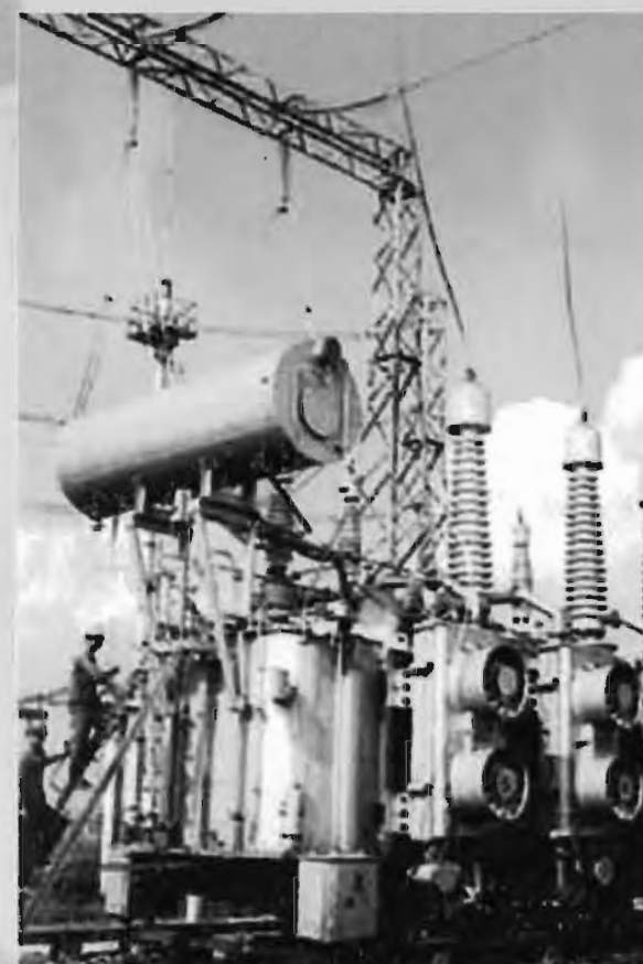
Máy biến áp 220KV. 220KV Transformer.
