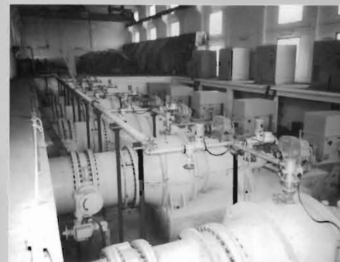
Trạm bơm nước Yên Sở - Thanh Trì - Hà Nội. The Yen So, Thanh Tri pumping station.
